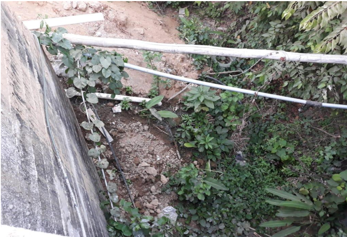
Figura 12. Mala conexión de tuberías de agua residuales Elaborado por: Equipo técnico de la actualización del PDOT
